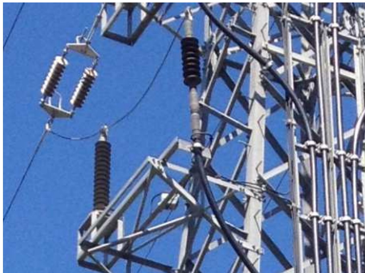
Foto 1. Unión conductor aéreo-pararrayos-terminal.
